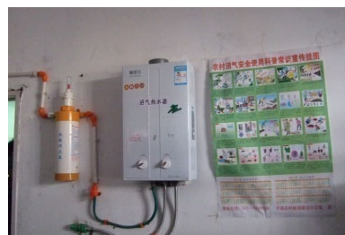
ガス温水器とシャワー
